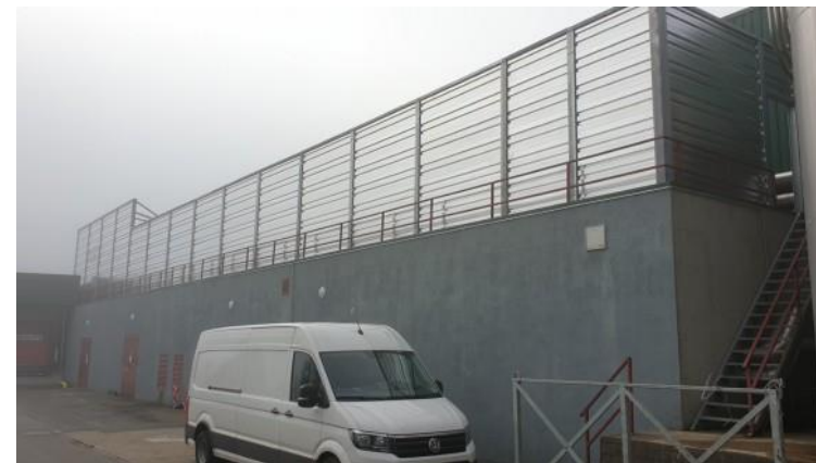
Cloison acoustique pour traiter les bruits à la source de l'industrie UNITED CAPS (batterie de ventilateurs et groupes froid)
